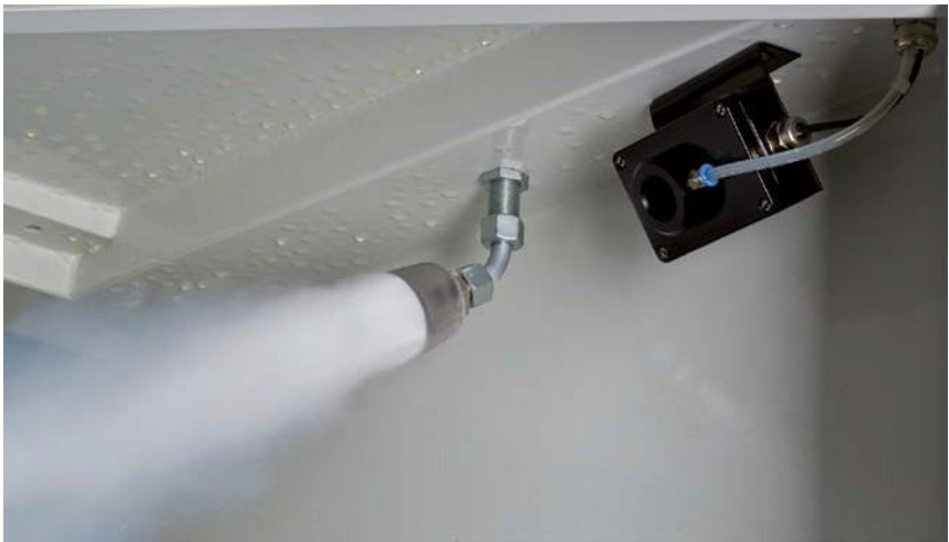
Figura 54 Bocal de extinção em operação
