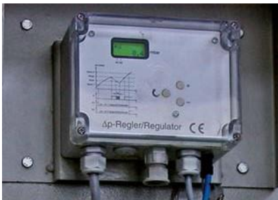
Figura 32 Controle de pressão
