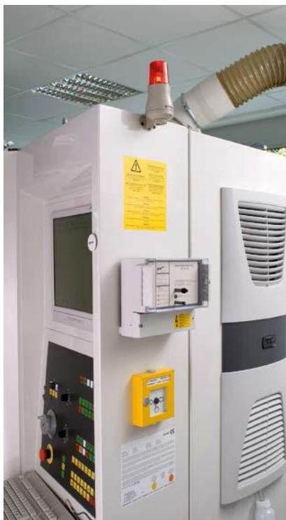
Figura 52 Central de alarme de incêndio com ativação manual
