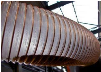
Figura 36 Acúmulo de óleo no duto de extração
