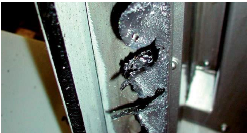
Figura 28 Vedação de porta inadequada para prevenção e proteção técnica contra incêndio
