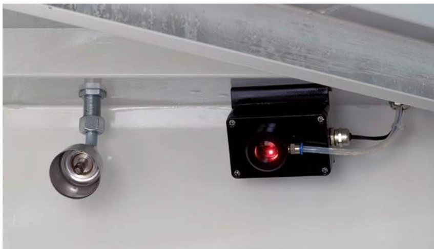
Figura 53 Elementos da detecção de incêndio (sensor óptico) com ar de purga
